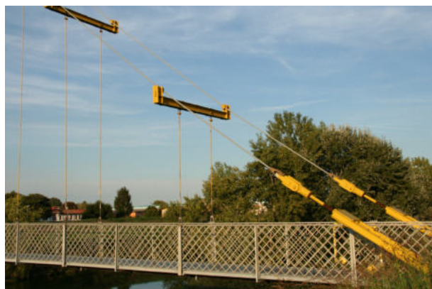
Fig. 19 - Passerella Benetti - I nuovi traversi per il collegamento dei pendini alle funi portanti e a destra il sistema di ancoraggio delle funi con attacco a cardano
