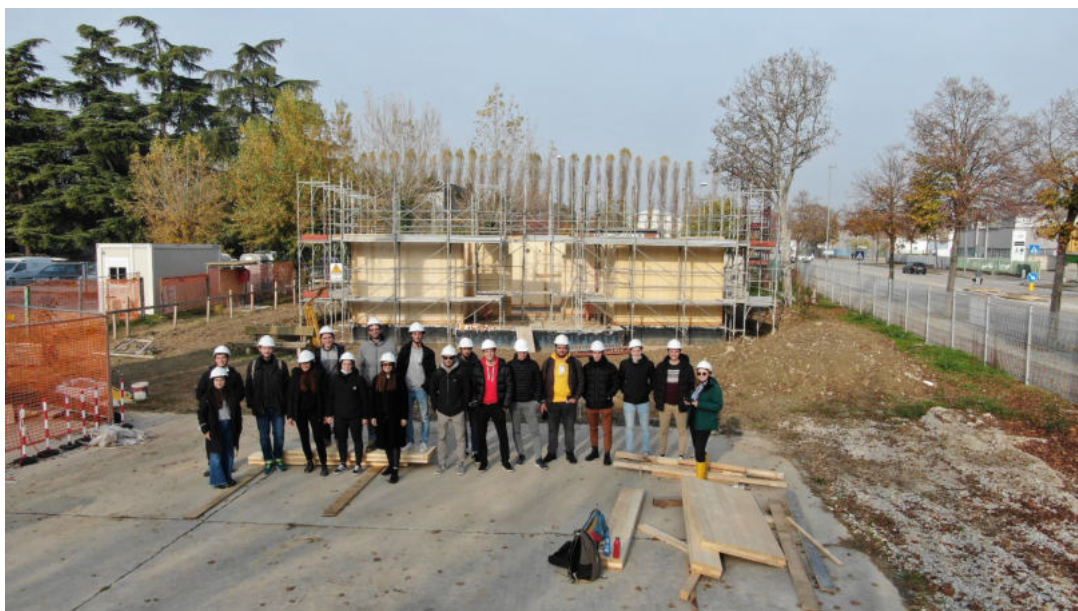
Fig. 1 - Membri del Team UniZEB nel cantiere del primo prototipo in costruzione presso la Scuola Edile Padova
