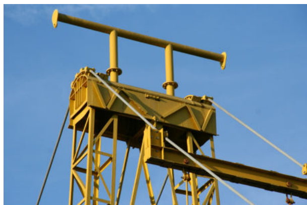
Fig. 18 - Passerella Benetti - La sommità della stilata con i rinforzi, le nuove selle e il telaio provvisorio, che non è più stato smontato
