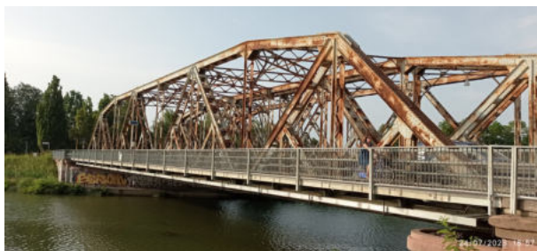
Fig.2 - Lo stato di degrado di alcuni ponti cittadini a causa della mancanza di manutenzione ordinaria (il ponte di Voltabarozzo sul Canale Scaricatore)
