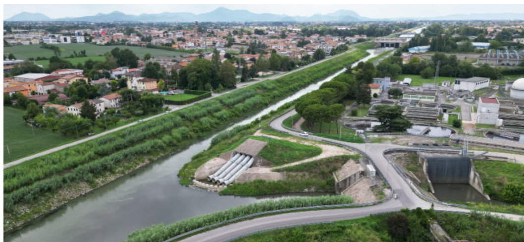
Fig. 1 – L'impianto idrovoro di Cà Nordio a Padova.
